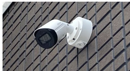
防犯カメラ設置 現場写真
