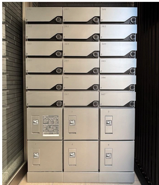
宅配ボックス設置後の様子
